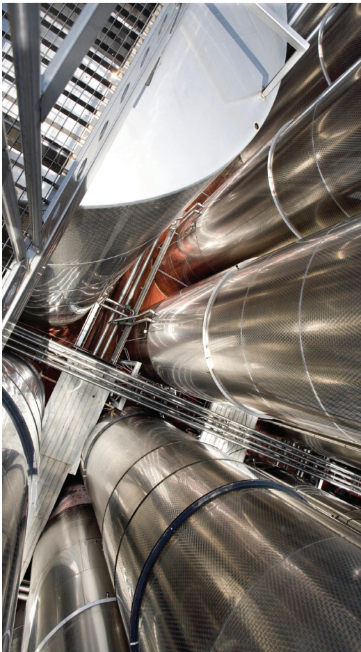
Silo, bồn chứa và phễu
